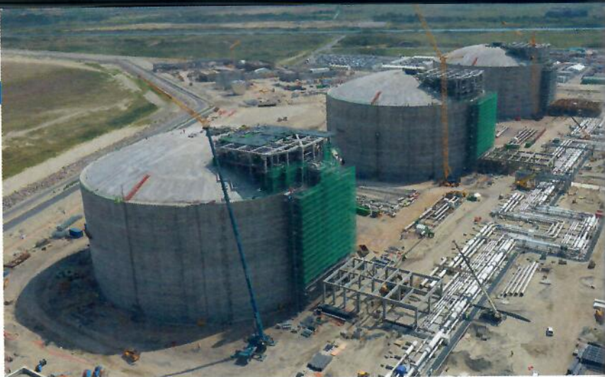
Le Groupe Altrad intervient sur différents chantiers, comme le terminal méthanier de Dunkerque.
